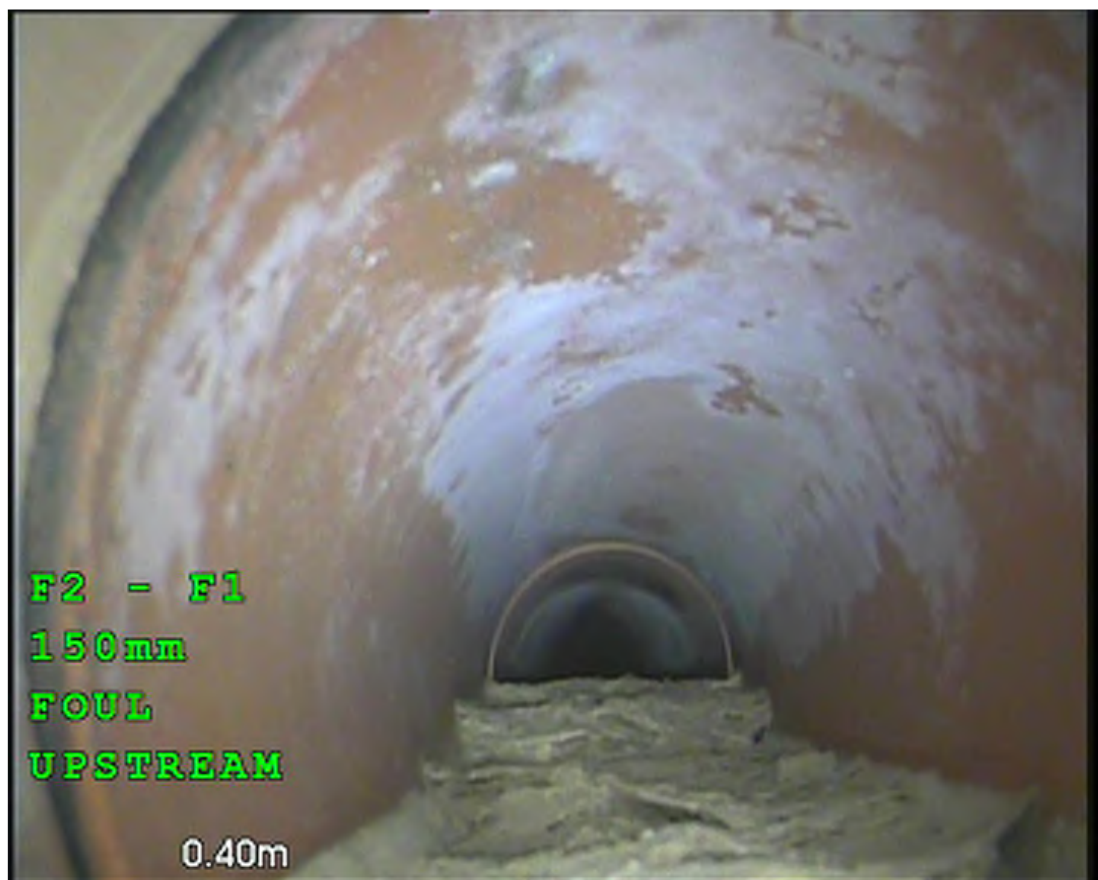
MH F2 – MH F1 50% DEBRIS
